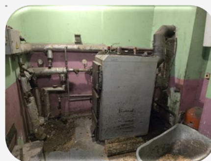
45. attēls. Internāta katls SC-90sv
