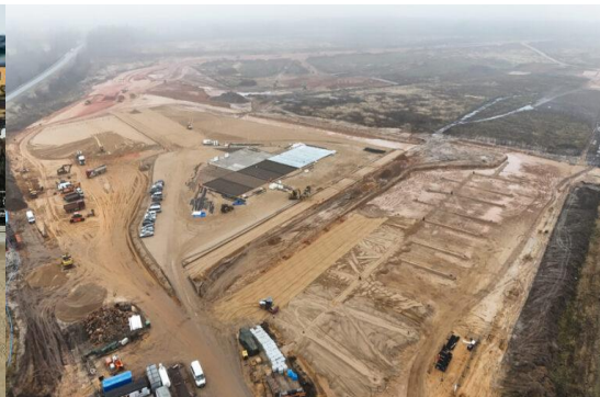
2. foto. Industriālā parka aero foto.
