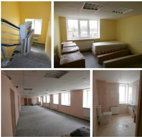
sociālās aprūpes centra ēkas telpas, kā arī uzstādīja pacēlājus centra iemītnieku vajadzībām,
